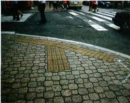
図 2-4 路面の凹凸があり誘導用ブロックの検知が難しい例
